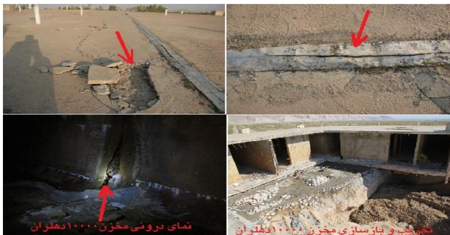
شکل ۸: ترک خوردگی دیواره و سقف مخزن بتنی ۱۰۰۰۰ مترمکعبی شهرستان دهلران بر اثر زلزله
