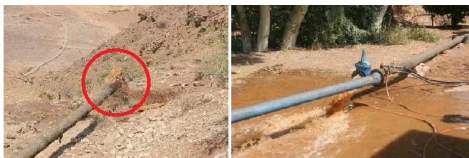
شکل ۹: آسیب خطوط آبرسانی و گل آلود شدن آب چاه شهر مورموری بر اثر زلزله
